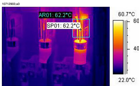
Abbildung 31.3 Ein Infrarotbild eines Sicherungskastens, das die maximale Temperatur anzeigt
