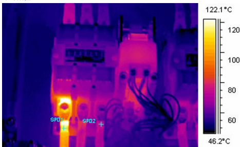
Abbildung 31.9 Ein Infrarotbild von elektrischen Innenanlagen (2).
