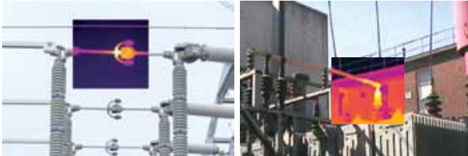
Bild-im-Bild bietet einen klaren Überblick über diese Hochspannungsanlagen.
