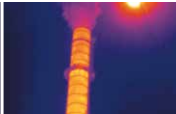
Untersuchung der feuerfesten Auskleidung am Schornstein eines Ofens.
